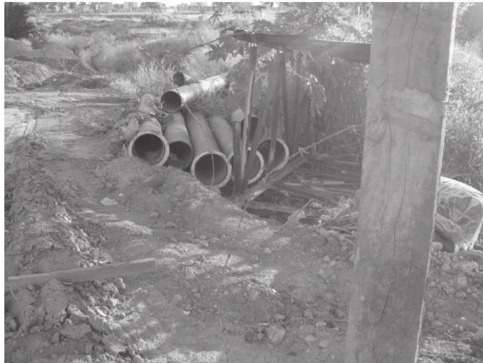
As obras da Marginal Cascavel, próxima da Avenida T-9, estão incompletas e abandonadas.
